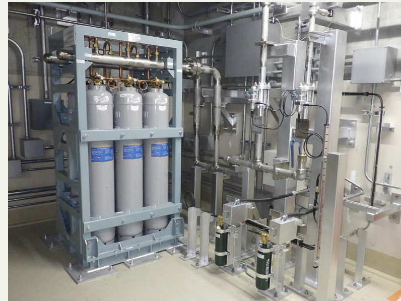
東北電力様 女川原子力発電所2号機
