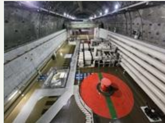
神流川発電所 (写真:東京電力リニューアブルパワー様提供)
