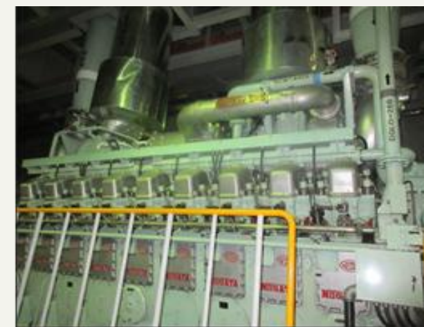
非常用ディーゼル発電機点検(常駐化実績) 写真:北陸電力様提供
