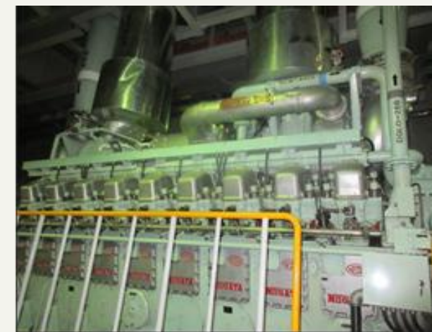
非常用ディーゼル発電機点検(常駐化実績) 写真：北陸電力様提供
