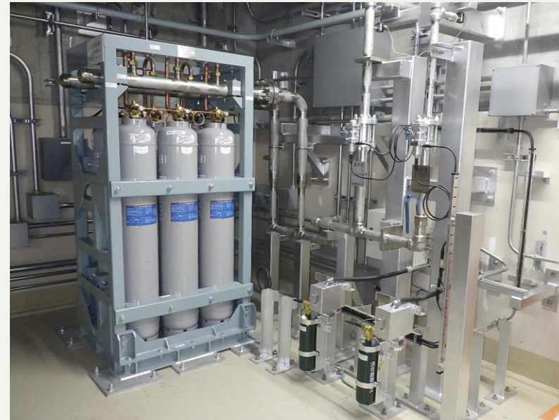
東北電力様 女川原子力発電所2号機
