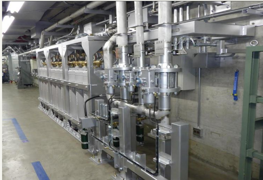
東京電力ホールディングス様 柏崎刈羽原子力発電所6, 7号機
